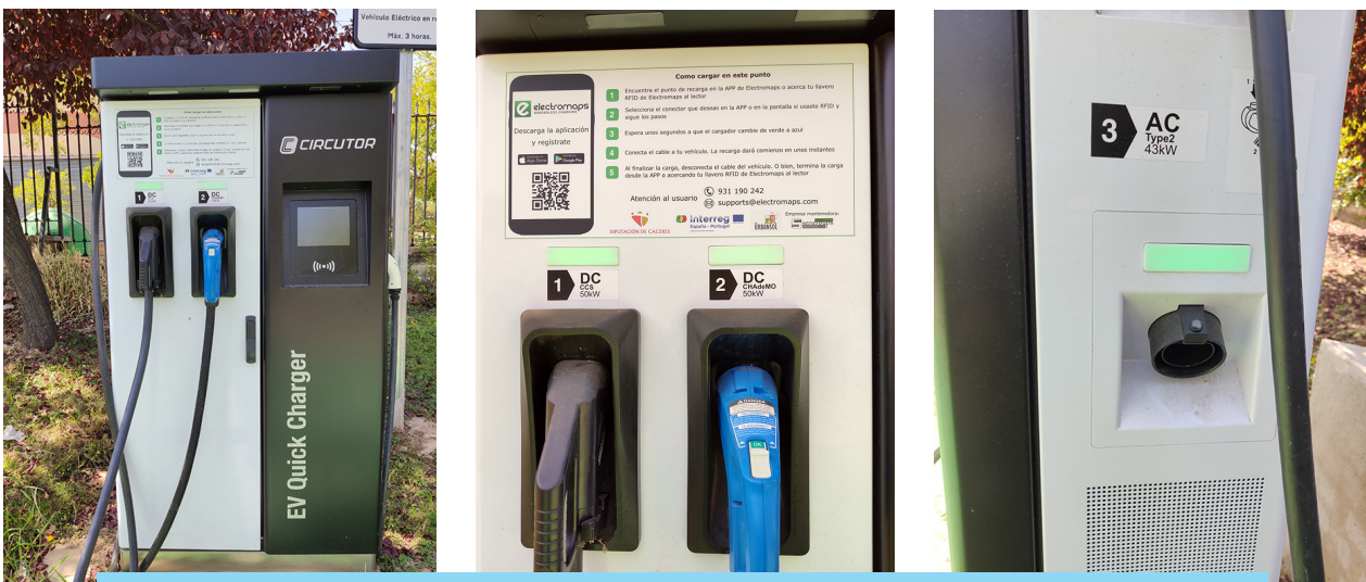
Imagen 24. Estación de recarga rápida “in itinere” con dos tomas de 50 kW en corriente continua y una toma de 43 kW en corriente alterna (“triformato”). Excm. Diputación provincial de Cáceres.
