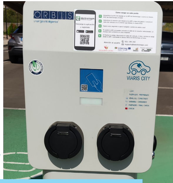
Imagen 25. Estación de recarga acelerada “en destino” con dos tomas de 22 kW en corriente alterna. Excm. Diputación provincial de Cáceres.
