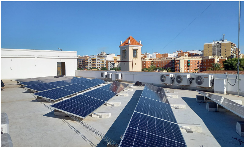
Imagen 29. Instalación F.V. sobre cubierta de las oficinas de la Agencia Extremeña de la Energía.
